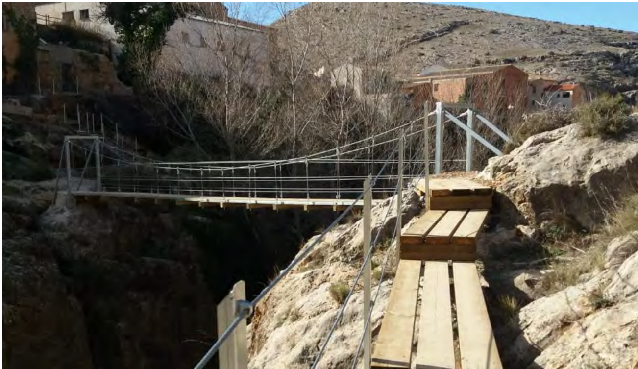
Una de las pasarelas instaladas en la presa. | Ayto. Almonacid de la Cuba
